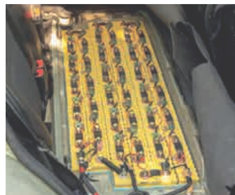
Store og/eller uovervåkte lagerområder for batterier
